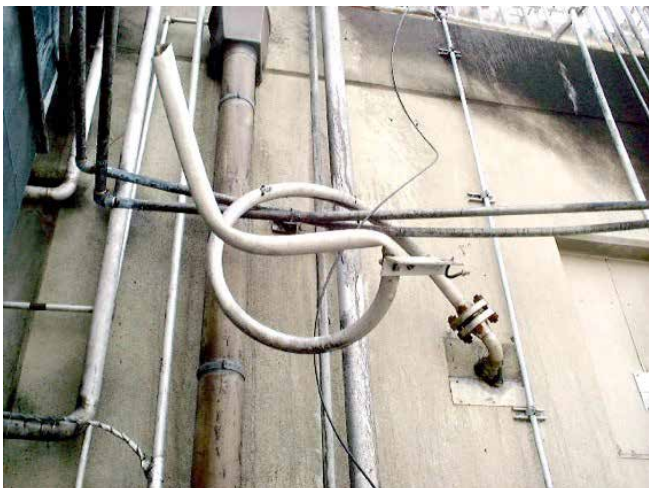
Línea de alivio doblada a causa de una explosión y de un soporte insuficiente.
