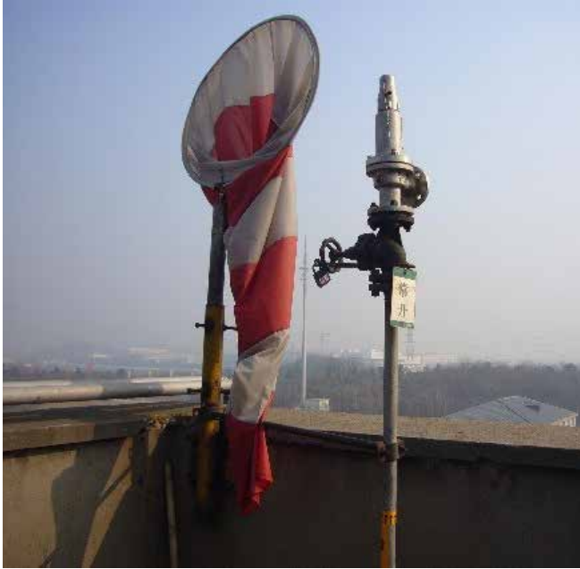
Válvula de alivio con soporte insuficiente y válvula manual
